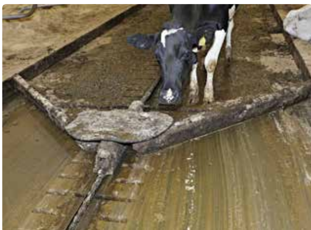
Figur 2.5 Fast gulv med langsgående drænkanel, som forebygger gylle-tsunami, dræn i U-skinne kan ikke gøre det.
